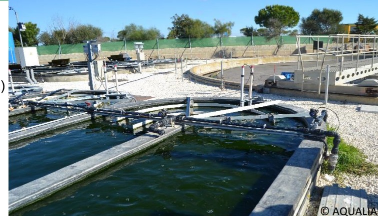
Σύστημα υψηλής συγκέντρωσης άλγης στην Ταϊκλάνα Ισπανίας, σε εγκατάσταση επεξεργασίας λυμάτων της εταιρείας AQUALIA για παραγωγή βιο-πλαστικών.
